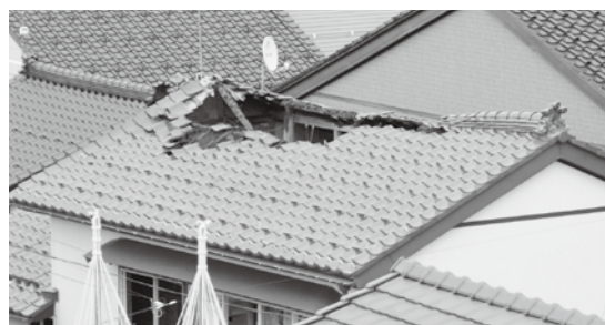
図1 飛び火被害を受けた家屋
